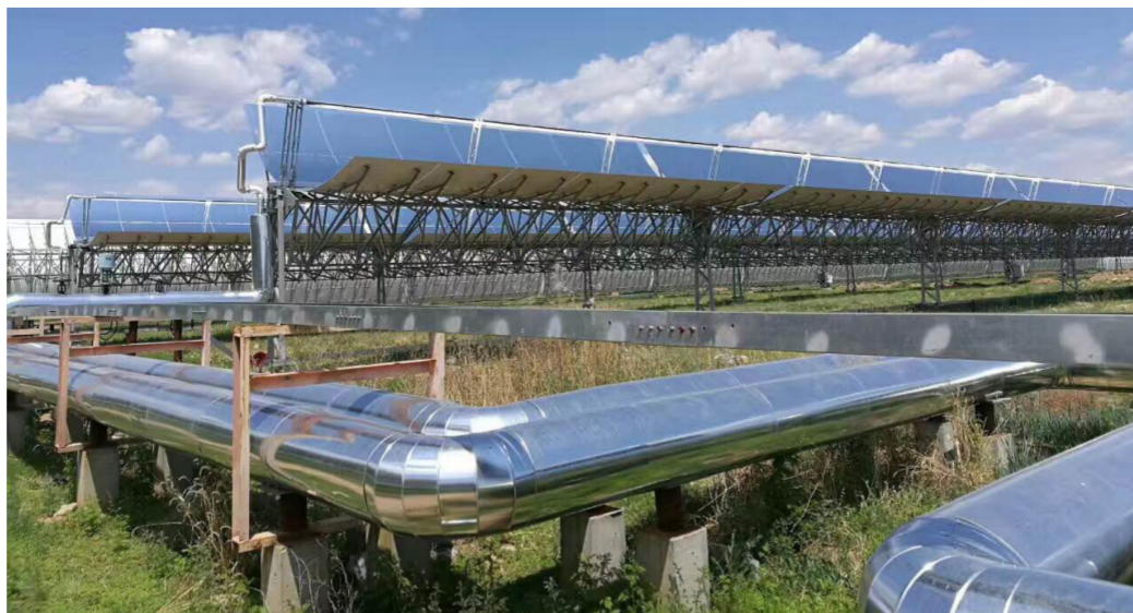
图 4.2-6 中国第一个 MW 级槽式光热系统（北京延庆，中国科学院电工研究所）
