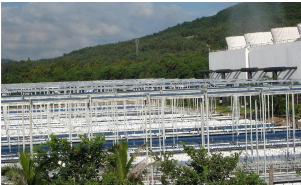
图 4.2-2 华能南山电厂太阳能热发电集热场全景（中国华能集团清洁能源技术研究院供图）
